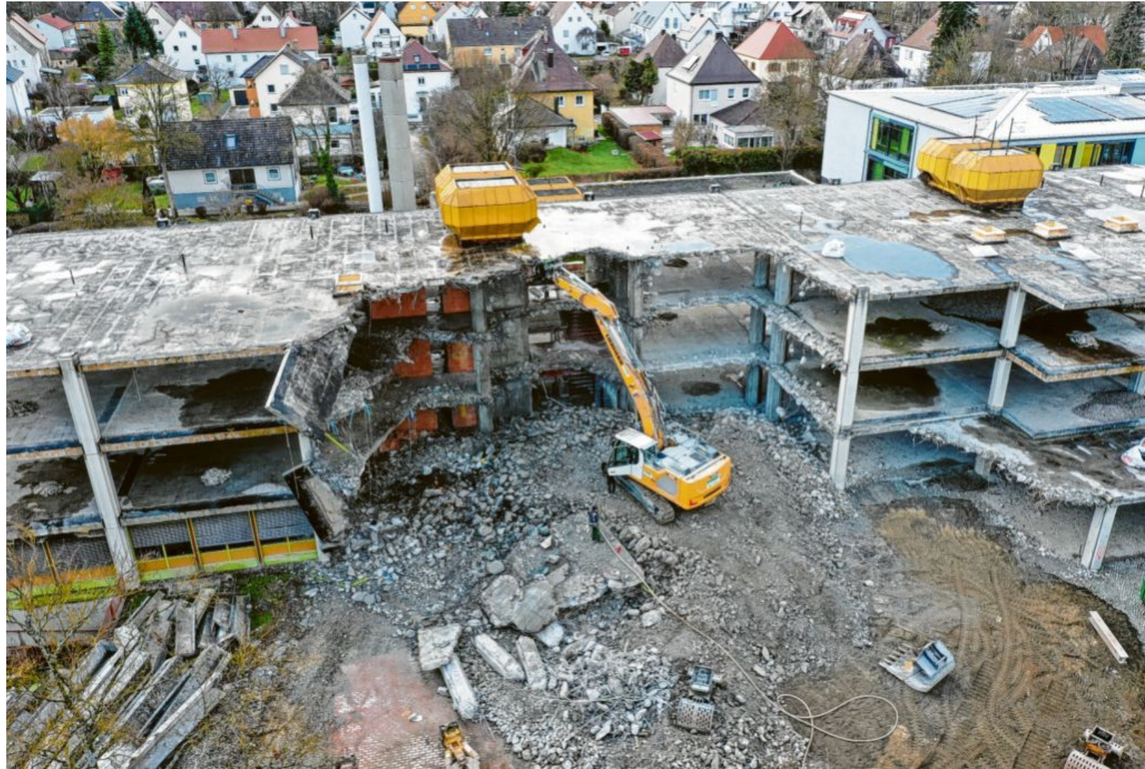
Eine Schule verschwindet: Das alte Schulgebäude der Josef-Anton-Schneller-Mittelschule wird abgerissen. Foto: Firma Fisel
