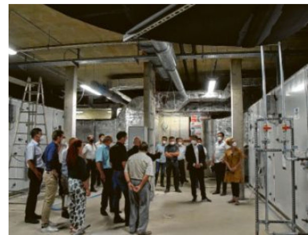
Zwei gigantische Lüftungsanlagen sorgen dafür, dass die Luft drei Mal pro Stunde erneuert wird.
