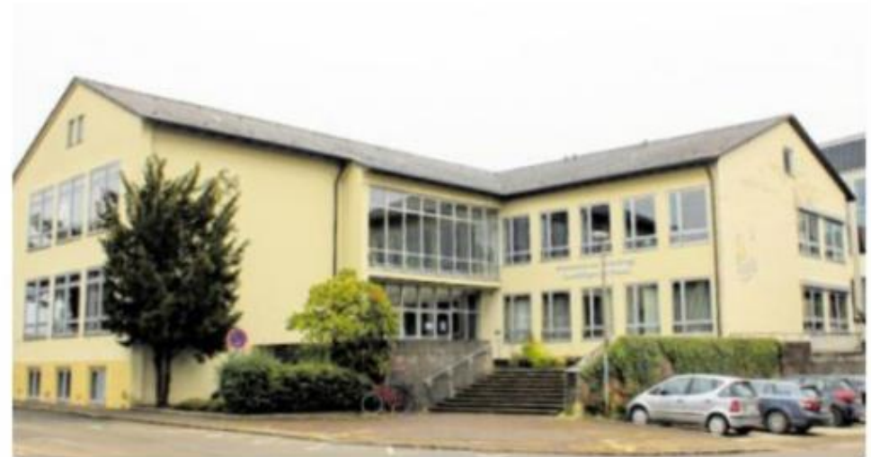
An der Mittelschule in Gundelfingen blättert der Putz von der Wand. Zumindest der Eingangsbereich soll nun einen neuen Anstrich erhalten. Foto: Tanja Ferrari
