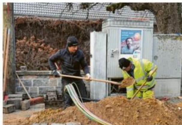
Die Mitarbeiter von nkb Netz und Kabelbau arbeiteten kürzlich am Verteilerkasten an der Binswanger Bauernstraße. Von dort aus verläuft die Glasfaser in Richtung Schule. Foto: Brigitte Bunk
